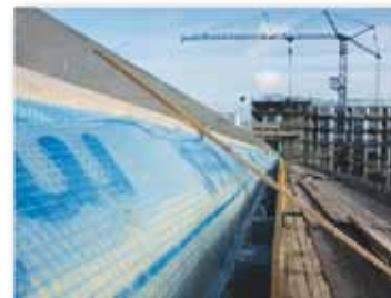
Fout: isolatie te laag.
