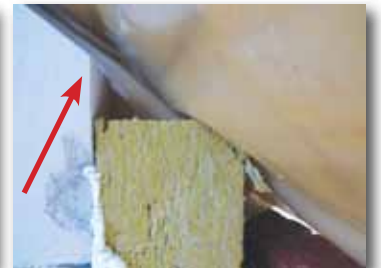
Fout: isolatieaansluiting gebrekkig.
