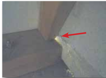
Fout: ontbrekende luchtdichting.
