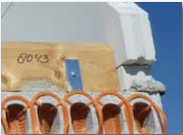
Fout: ontbrekende luchtdichting.
