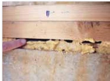
Fout: gebrekkig aangebrachte pur.
