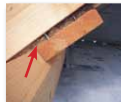
Fout: ontbrekende luchtdichting.
