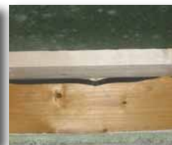
Fout: ‘vershoven’ luchtdichting.
