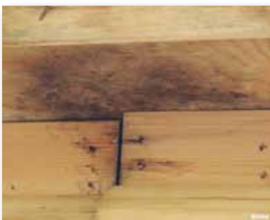
Luchtlekken in de dakvoet met beginnende houtrot als gevolg.
